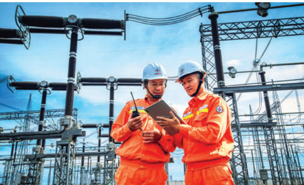
Sử dụng thiết bị thông minh để kiểm tra vận hành tại TBA 500kV Di Linh
