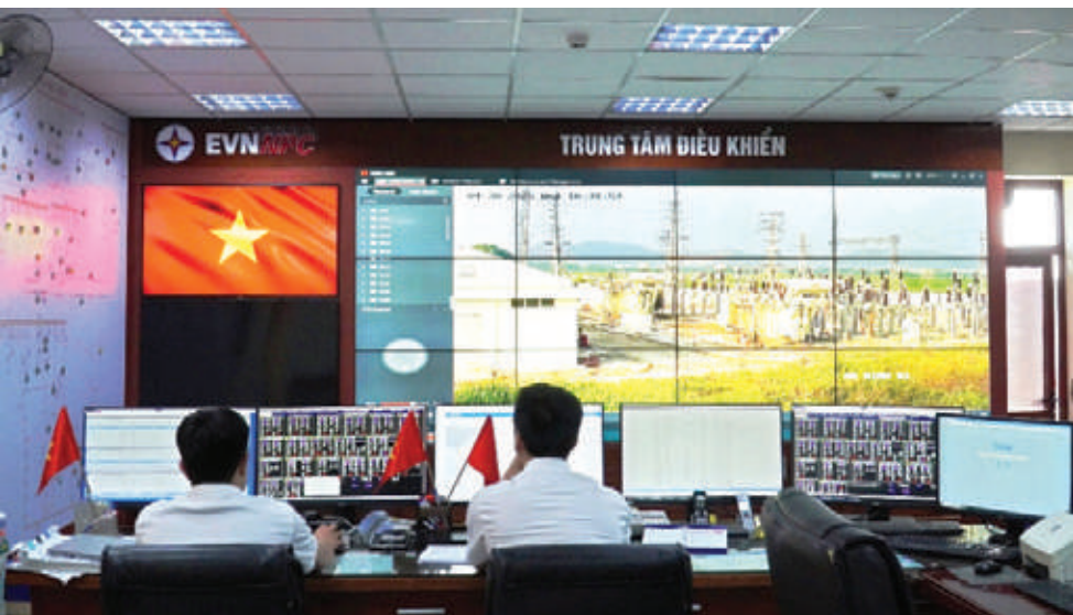
EVNNPC hoàn thành chuyển đổi 100% các TBA 110kV sang mô hình vận hành không người trực
