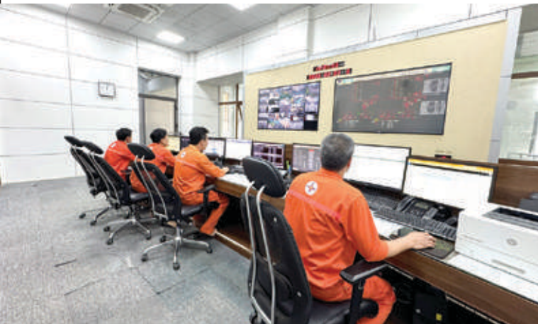
Các kỹ sư Nhà máy Thủy điện Quảng Trị trực vận hành ngày 07/3/2026
