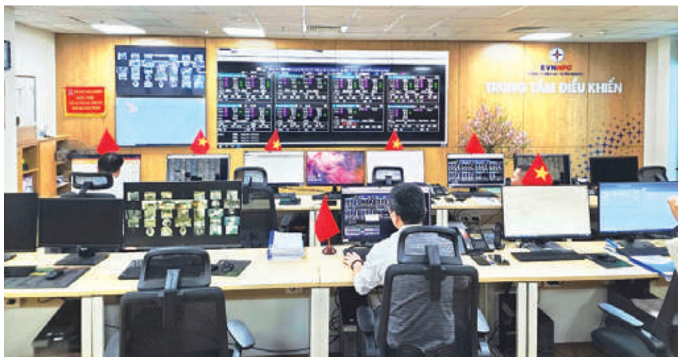
Các TBA 110kV của EVNNPC hiện đã được kết nối giám sát và điều khiển từ xa thông qua hệ thống SCADA
