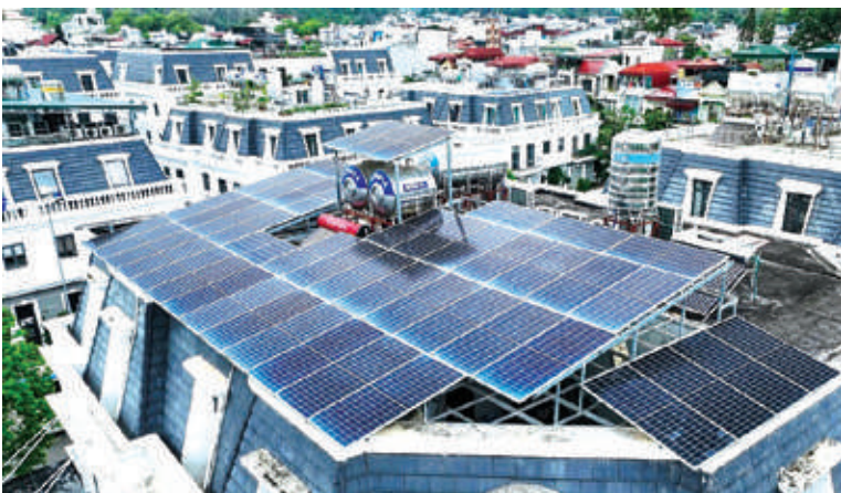
Hệ thống ĐMTMN được nhà dân lắp đặt tại tỉnh Sơn La
