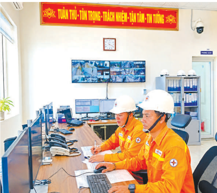
Nhân viên Trạm biến áp 500kV Thanh Hóa ứng trực 24/24 giờ, giám sát chặt chẽ thiết bị nhằm bảo đảm nguồn điện an toàn, liên tục cho miền Bắc
