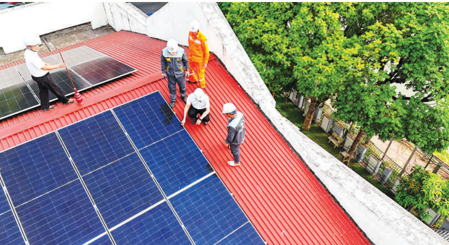
Cán bộ kỹ thuật Công ty Điện lực Cao Bằng kiểm tra hệ thống ĐMTMN tại trụ sở đơn vị
