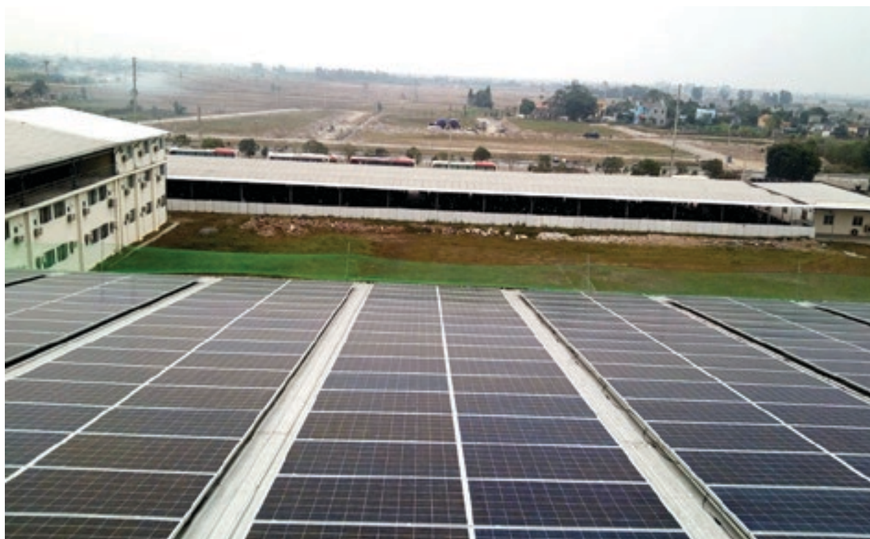
Cung cấp và lắp đặt hệ thống pin NLMT nổi lưới công suất 3628.8 kWp tại Công ty TNHH Creative Source Việt Nam
