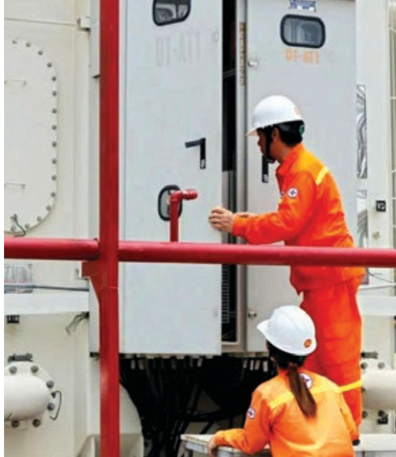
Công nhân TĐĐ Đông Bắc 2 kiểm tra thiết bị ngoài trời để chủ động kiểm soát những yếu tố bất lợi trong vận hành
