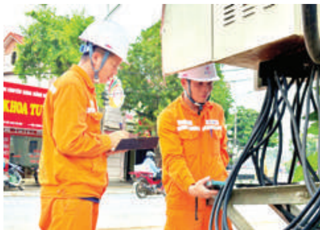
PC Phú Thọ chủ động kiểm tra hệ thống lưới điện nhằm nâng cao độ tin cậy cung cấp điện
