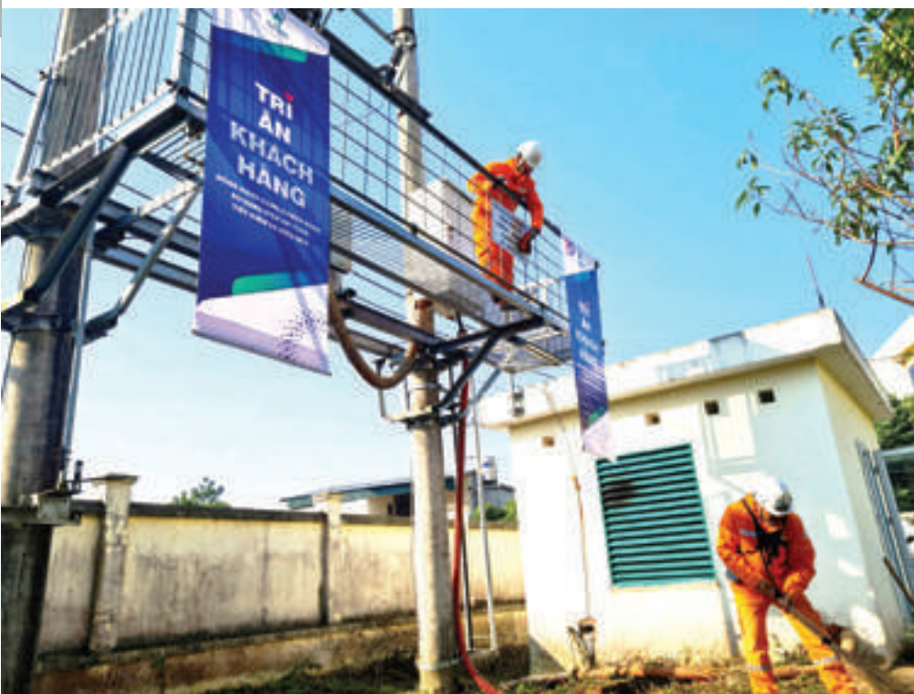
Công nhân Điện lực Bình Liêu vệ sinh TBA Trung tâm Hành chính công huyện Bình Liêu 100 kVA-35/0,4 kV
