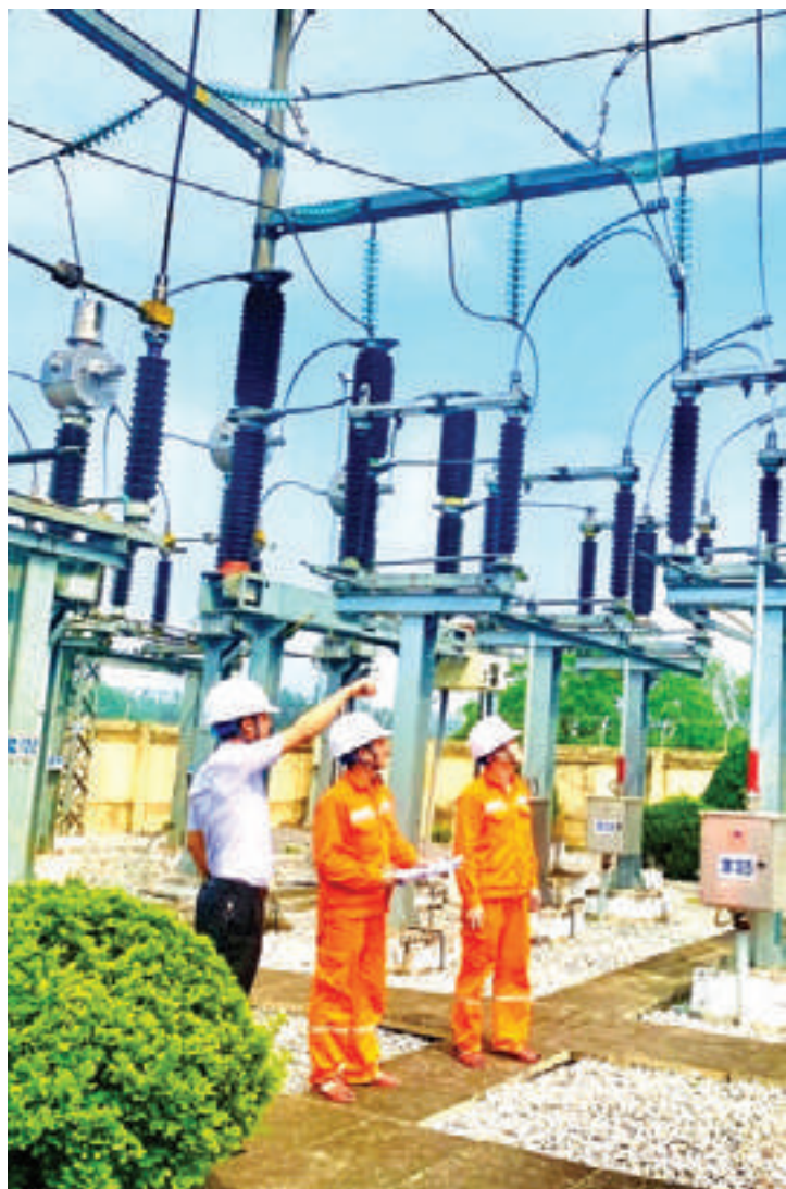
Công nhân PC Phú Thọ kiểm tra các thiết bị ngoài trời thuộc trạm biến áp 110kV
