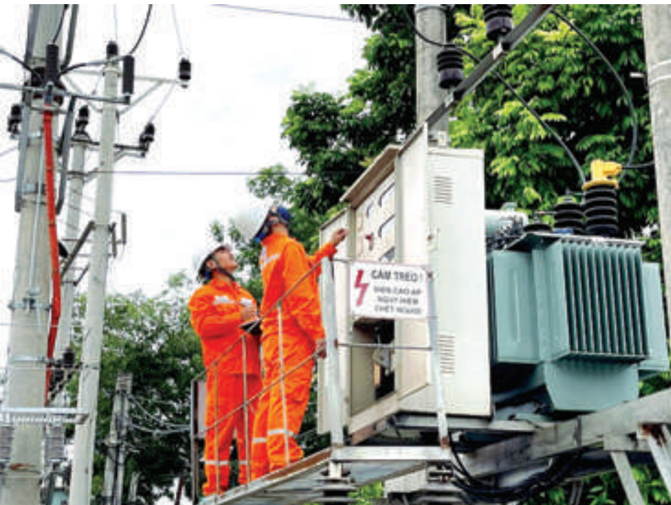
Công nhân Điện lực khu vực Như Thanh - Như Xuân kiểm tra vận hành lưới điện
